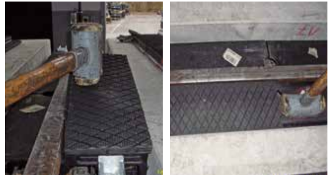
Faire rentrer et aligner les éléments profilSTRAIL en se servant du marteau.
